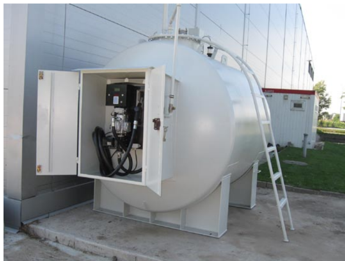
Zbiornik o pojemności ??? tys. litrów. Doskonale widoczny panel dystrybucyjny
